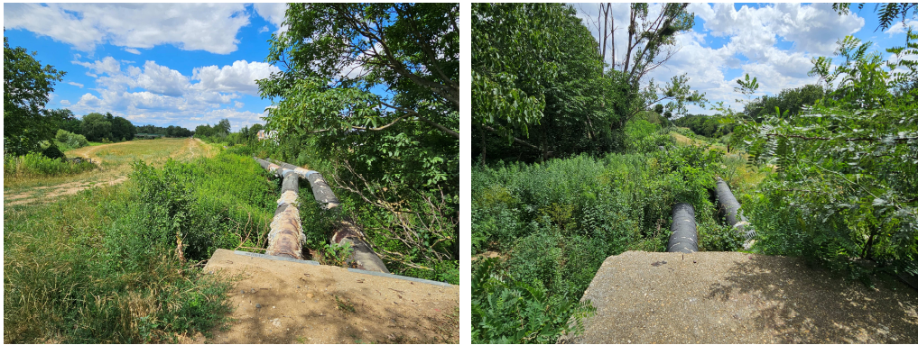
Távhővezeték a tervezett kerékpárúttól keletre
